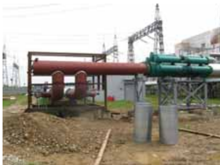
Фото 1. Использование СДТ 16-700-10 на Балтийской электростанции в Нарве (Эстония).
